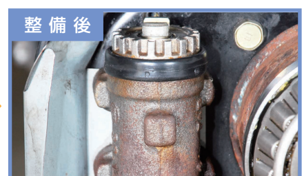
ホイール・シリンダから液漏れがなく、ゴム部品が新品の状態
